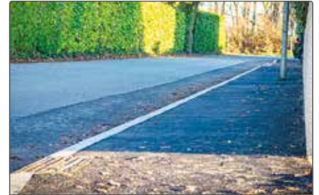
Le nouveau trottoir de la rue des Mousserons permet désormais de relier l'avenue Denis Touzanne en toute sécurité.
